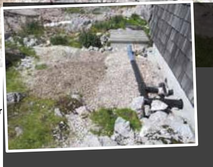
Einleitung in die Filterstrecke der Abwasseraufbereitungsanlage.
